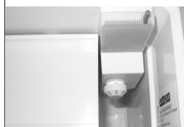
Alternatieve plaatsing thermostaat in CR 49 en CR 65, in verlichtingsarmatuur.
